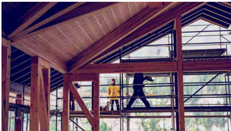
Le chantier du futur centre de yoga de Solange Demole, réalisé par Charpente Concept.
